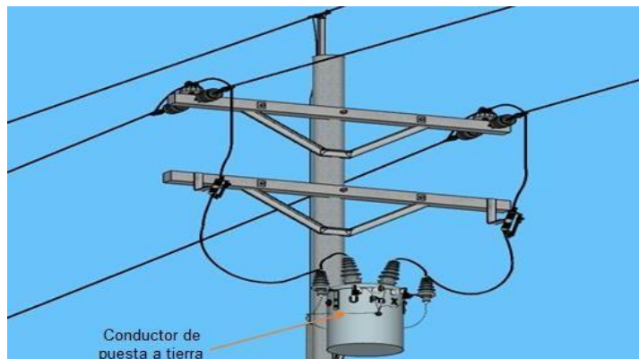
Figura 6. Montaje con transformador autoprotegido y cable de guarda
